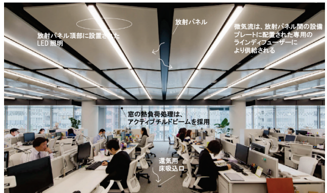
図2 微気流併用放射空調による室内放射環境制御
