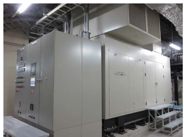
図 34 混焼エンジンエンクロージャー
