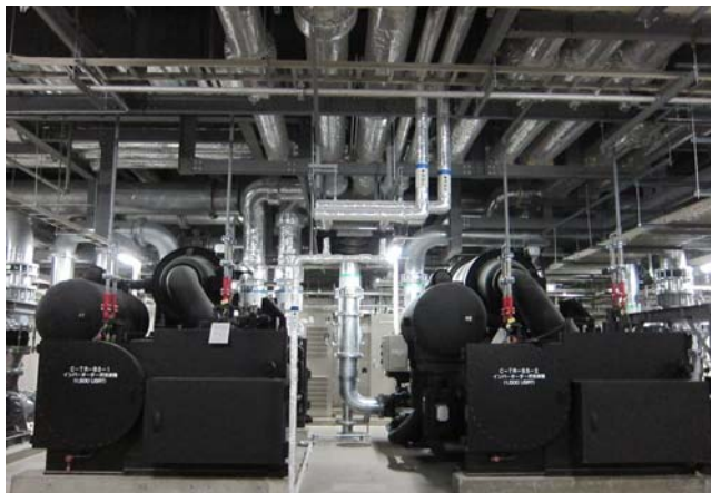
図 33 インバーターボ冷凍機
