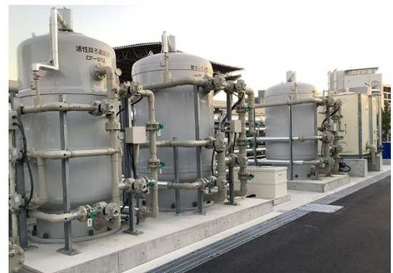
写真 2. 井水処理設備
