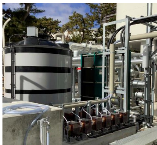
写真 10. 凝集剤注入装置
