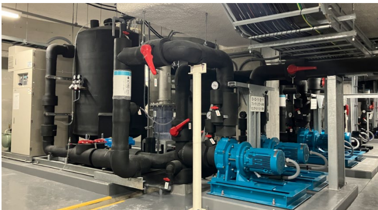
写真 7. オゾン処理装置外観
